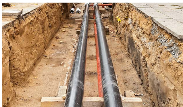
Abbildung 12: Fernwärmeleitung (Quelle: Fotolia.com/feufoto)
