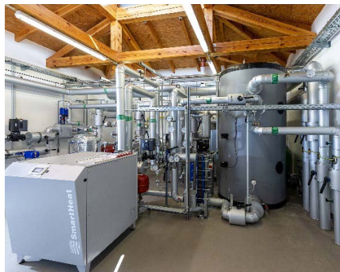
Abbildung 15: Heizwerk Prenzlau (Quelle: SWP)
