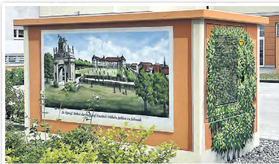
Die Trafostation der Stadtwerke Schwedt auf dem Innenhof vom Augustiner Tor.
